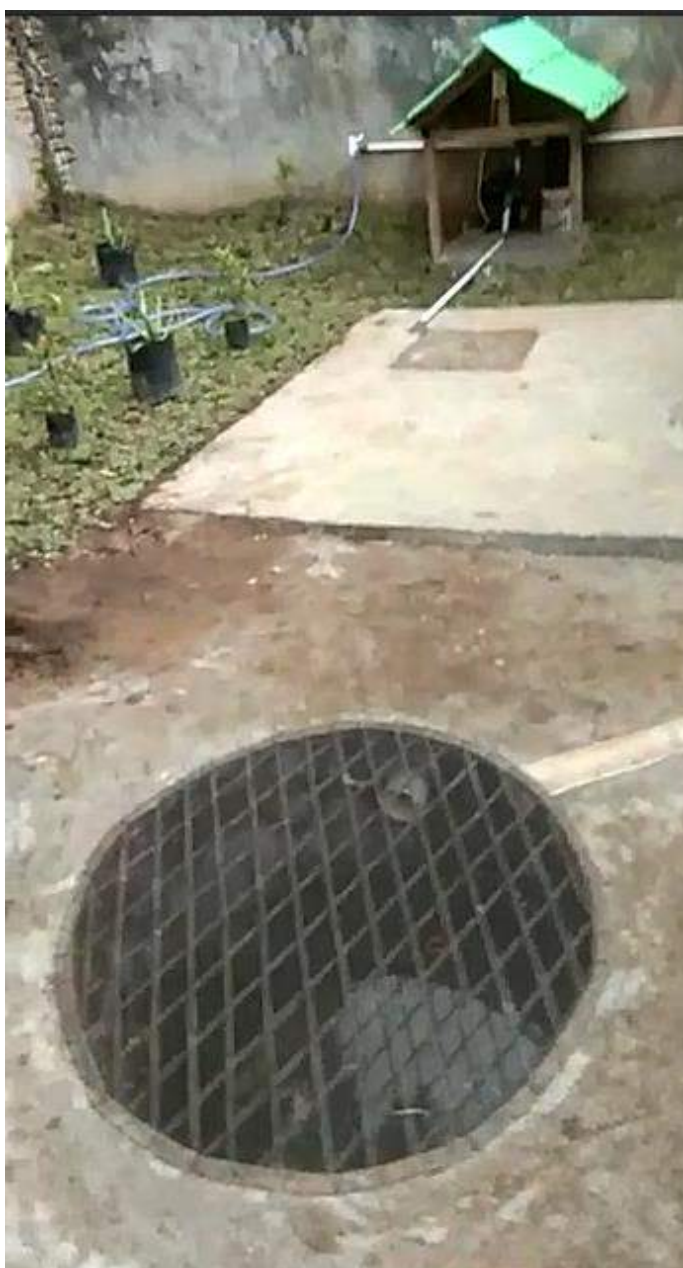
Gambar 4.5 Resapan dan Ground water tank yang dimanfaatkan untuk pemeliharaan lansekap (sumber : Penulis, 2021)
